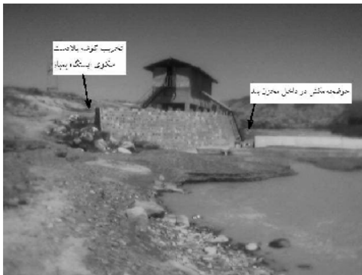
شکل (۴): نمایی از فرسایش سکوی ایستگاه پمپاژ ساحل راست
